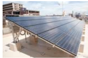
太陽光パネル
